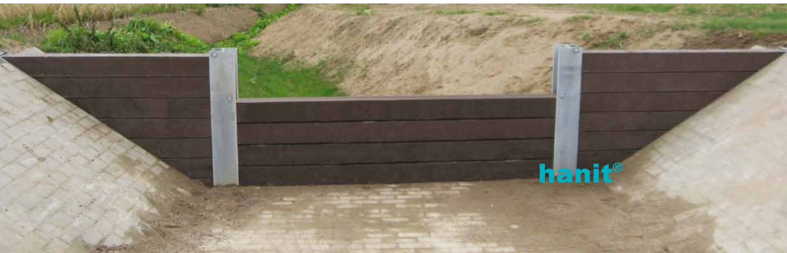
Siebanlage/Vorfluter aus hanit®
